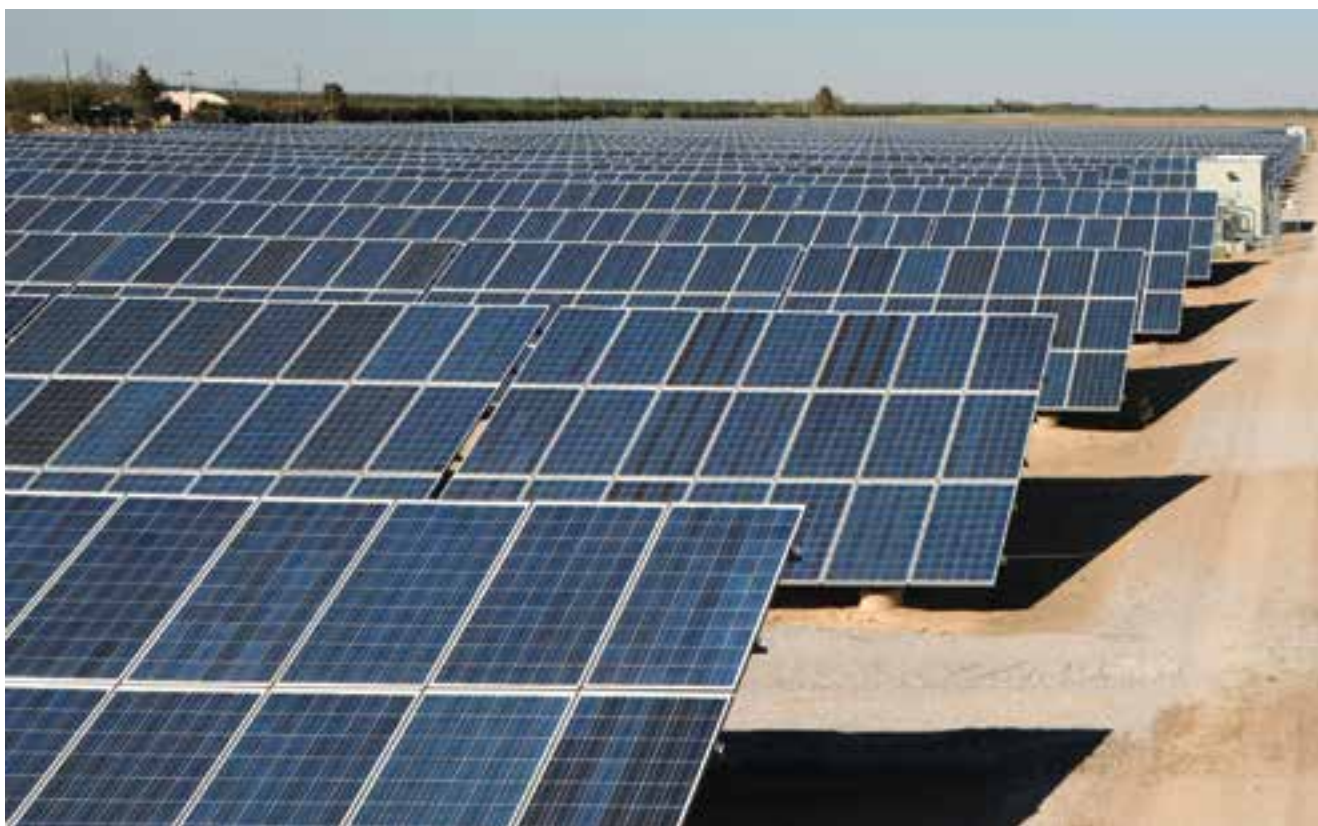
Central fotovoltaica Cañada Honda, situada a unos 60km de la ciudad de San Juan. Con 33.500 paneles fabricados en España, colocados en filas separadas por 10,5m e inclinados 28° con respecto a la horizontal para estar en la mejor posición de recibir el sol, tiene una potencia de generación de 7MW.
