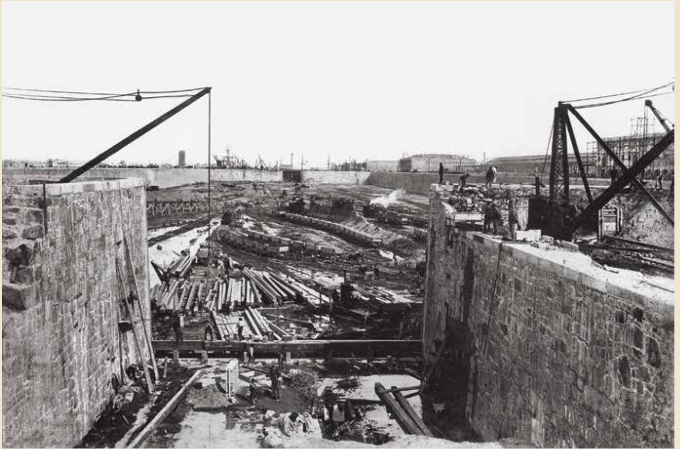
Puerto Madero en construcción. Foto de Samuel Rimathé, ca. 1890, Biblioteca Manuel Gálvez. Muestra las obras del dique 2 y da una idea gráfica de la magnitud del esfuerzo.
