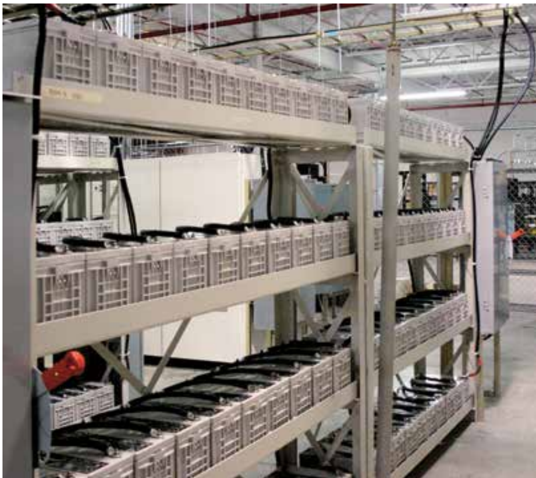
Figura 6. Banco de baterías de plomo-ácido instaladas en el centro de datos de Atlanta, Georgia, como parte del sistema de emergencia que opera en casos de corte de electricidad. Foto Tim Dorr, Flickr.
